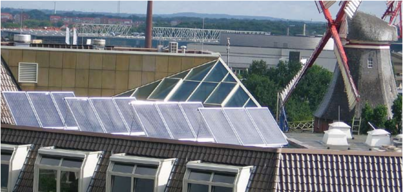
Solaranlage auf unserem Verwaltungsgebäude in Bremen
